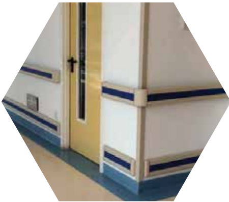
TAY VỊN HÀNH LANG THANH CHỐNG VÀ ĐẬP BỆNH VIỆN
